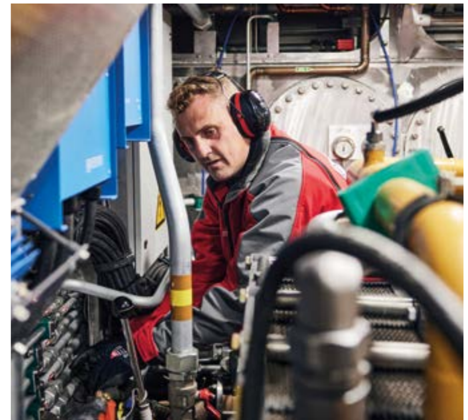
Philipp Schuur ist verantwortlich für die Abläufe und die Wartung im Maschinenraum.
